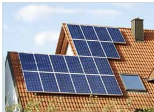
Installation résidentielle - système surimposé sur la toiture
