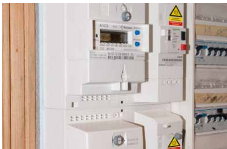
— Présence de deux AGCP signalée par les étiquettes normalisées
