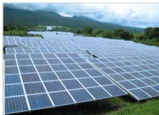
Centrale solaire au sol - panneaux montés sur structure fixe
